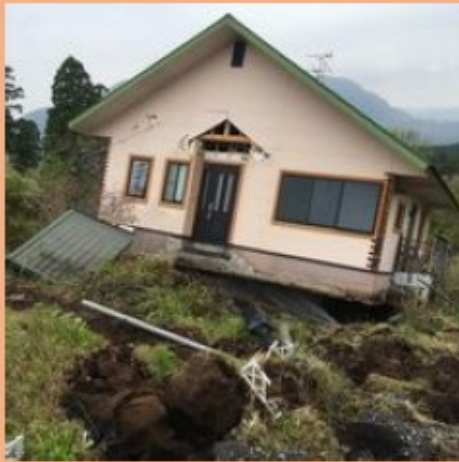
H28熊本地震による被害状況(南阿蘇村)
